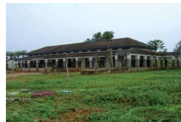
III. 19.4. Une vue extérieure de l'hôpital de référence de Kungu dans un état de délabrement avancé en 2009. (Photo équipe locale, 2009.)
